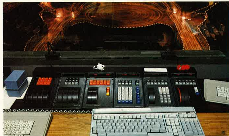
▲ Die Steuerung des konventionellen Lichts.
